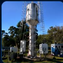
INFRAESTRUTURA 4G Estação Rádio Base
