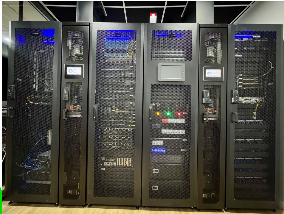
Sala de Equipamentos
